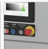
Parada de emergência
